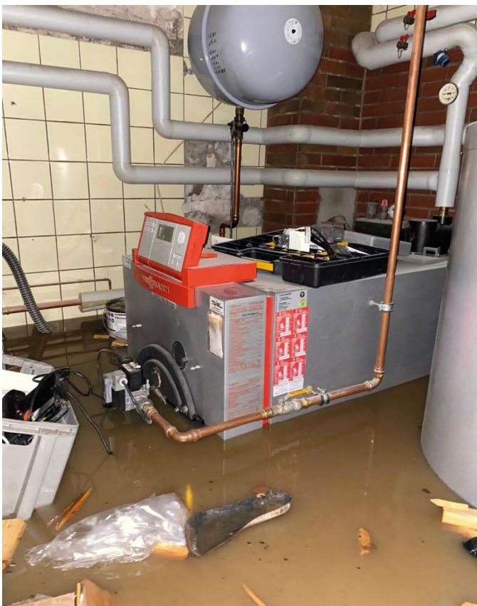
Flutschaden im Keller: Beschädigte Anlagen waren auch Anlass, auf ökologisch sinnvollere Heizungen umzusteigen.
